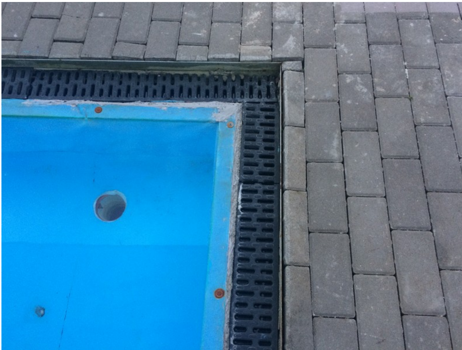
Batoľatá - nová dlažba, nebezpečné ostré okraje betón + železo zostali nekryté
