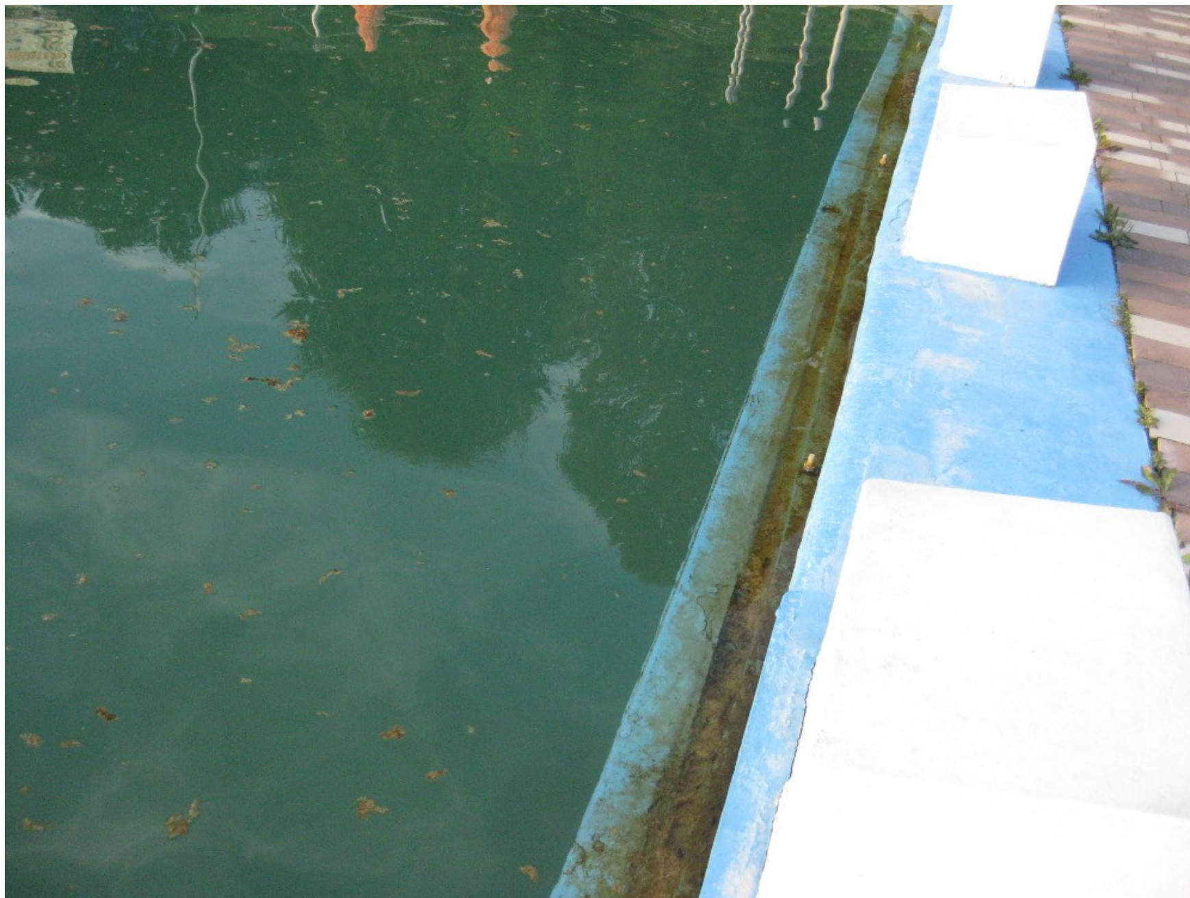
Staré stupne nabielené, bazén sa stále rozpadá, trčiace roxory pri stene.
