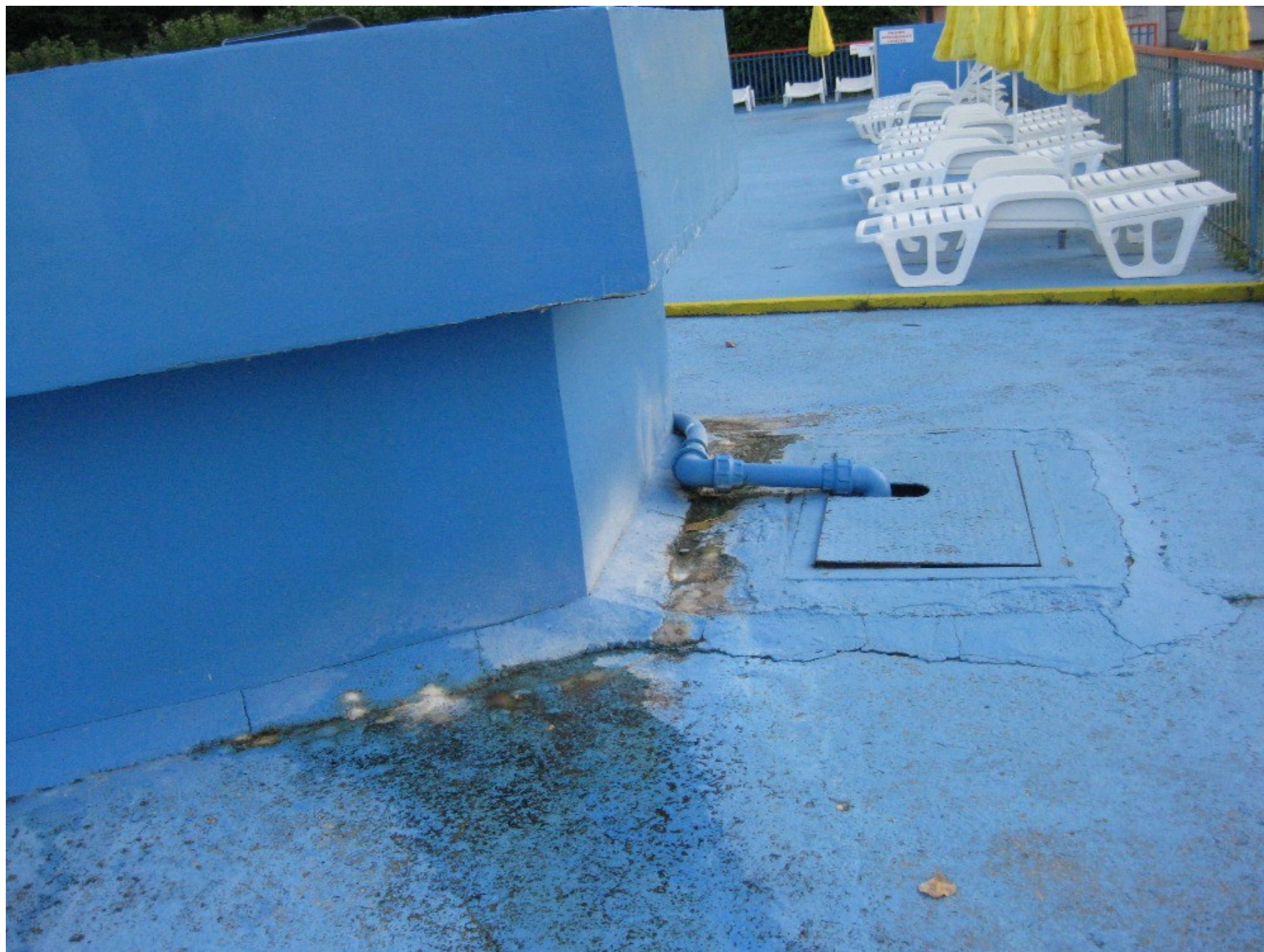
Žltý schod a kanál – a všade smykl'avá modrá farba.
